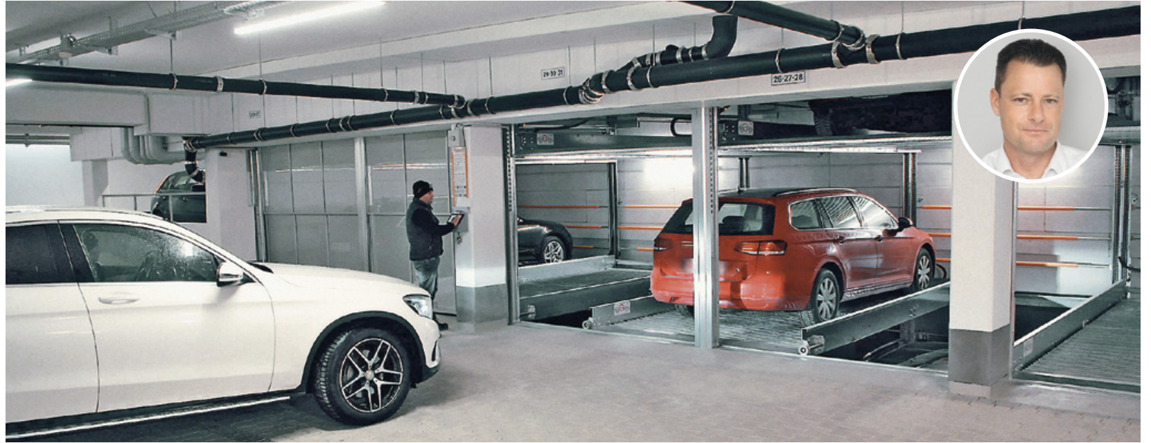
Mit dem halbautomatischen Parksysteem TrendVario 6300 haben wir in Memmingen 19 statt sieben Stellplätzen geschaffen und entscheidend dazu beigetragen, den Stellplatzschlüssel der Stadt zu erfüllen. Rechts im Bild: Area Sales Manager Thomas Röllig.
